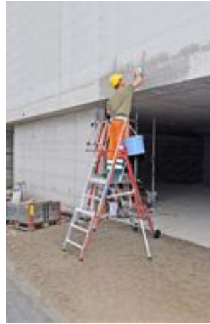
Hohe Standsicherheit und Stabilität dank rutschsicherer Stufen und Sicherungsgeländer: Das teleskopierbare Modell Hymer ProTect+ 8484 im Einsatz.
