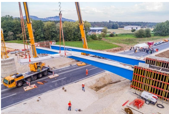
Bild 3) Einheben der ersten Fahrbahnplatte der Segmentbrücke Bögl an der Ortsumgehung Mühlhausen. Bildnachweis: Reinhard Mederer
