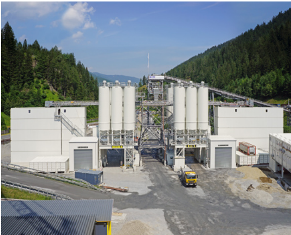
Bild Nr. 17-04 BT_LH-BrennerBasisTunnel.jpg. Beim Bau der weltweit größten Schleuse in den Niederlanden sind Liebherr Mischanlagen für die Betonherstellung genauso aktiv, wie beim Brenner Basistunnel (Foto).
